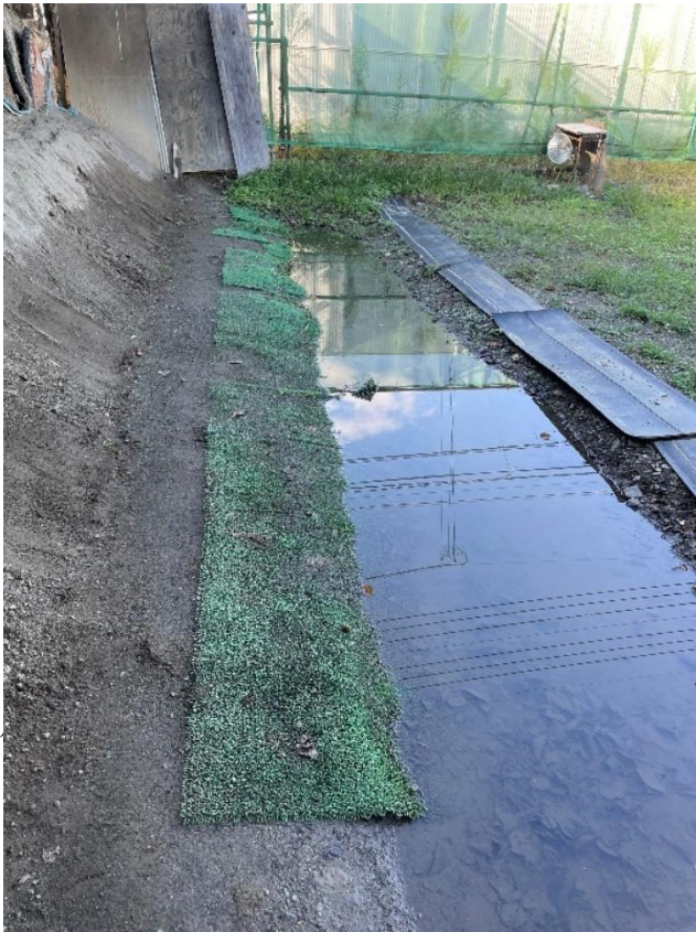
写真1 現状 矢道に溜まった雨水
